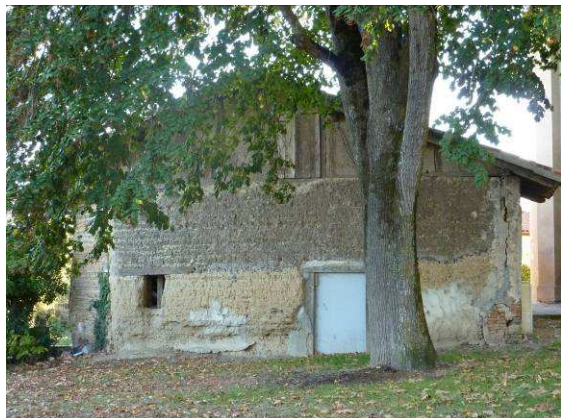
Construction en ruine : maison la plus ancienne du village présentant une architecture typique rurale assez pauvre
